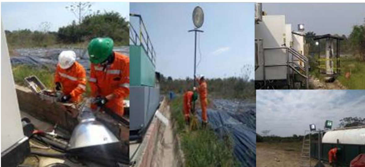
Ilustración 4. Instalaciones eléctricas. Trabajos por parte del área eléctrica y de Campamenteros en la instalación de Cuatro lámparas en las áreas de campamento. Departamento de QHSES de Petrex Sucursal Colombia. Reporte diario HSE 03/05/2018. Reimpreso con permiso.
