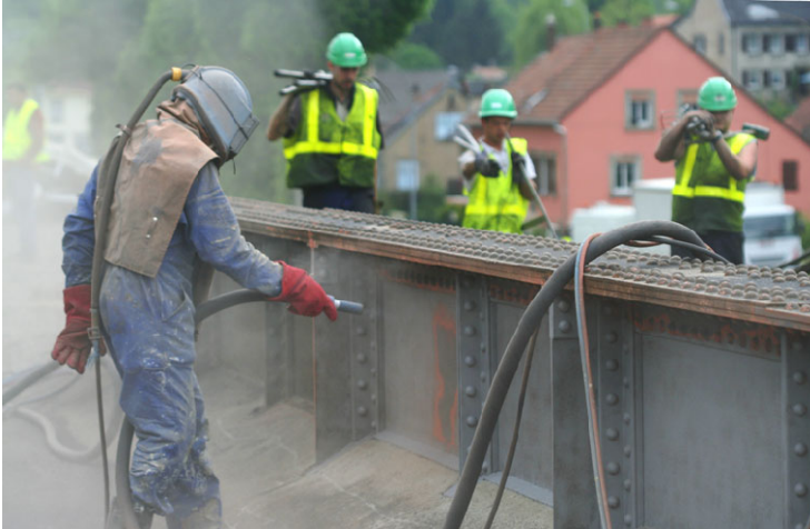
Abb. 2 Beim Sandstrahlen von Brücken und anderen Stahlkonstruktionen handelt es sich um eine physisch extrem fordernde Tätigkeit. Ein Roboter (z. B. von Sabre Autonomous Solutions) kann dem Menschen diese belastenden Tätigkeiten abnehmen. Quelle: herreneck/Fotolia.com
