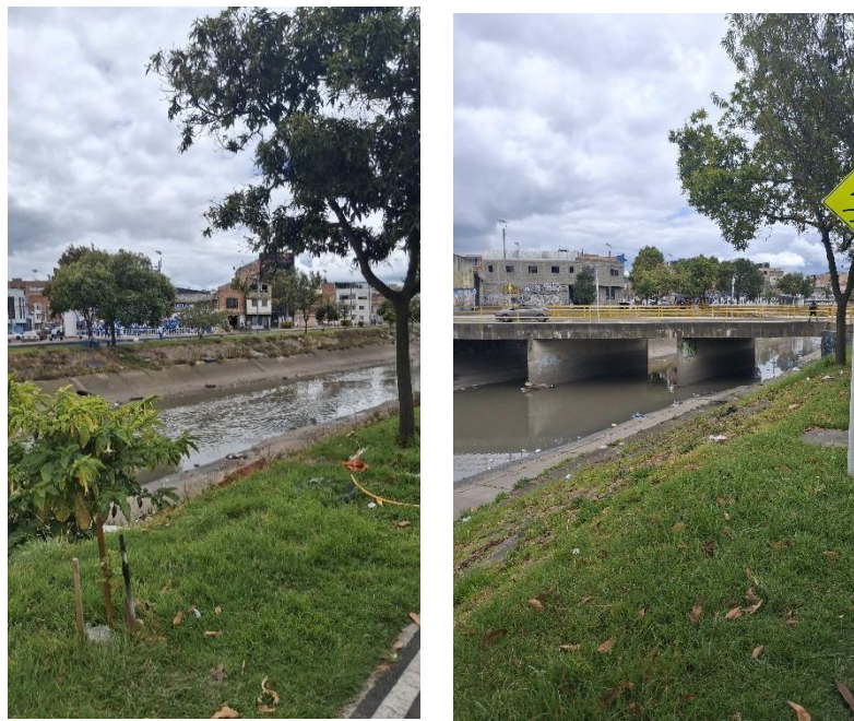
Figura 3: Condición actual del canal Arzobispo a la altura del barrio.
