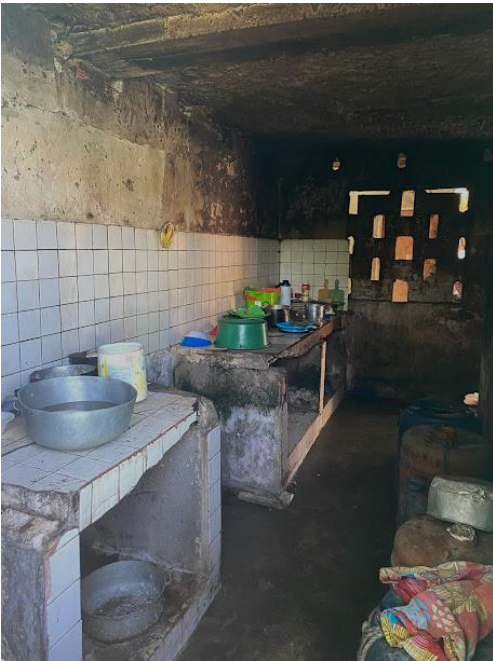
Imagen 55. Estado de cocinas de viviendas
