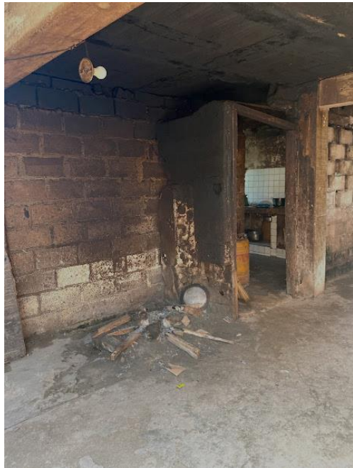
Imagen 56. Afectación del humo en viviendas
