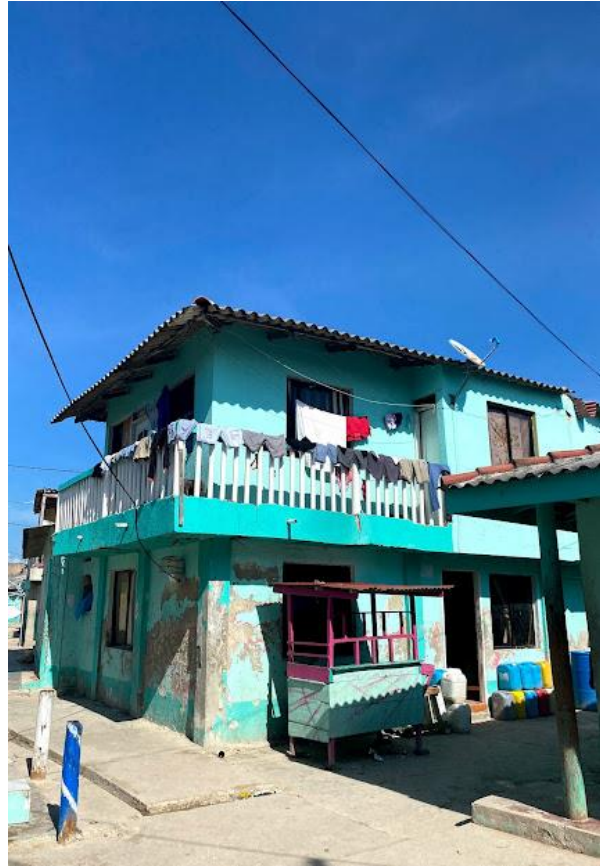
Imagen 42. Estado de viviendas de dos pisos
