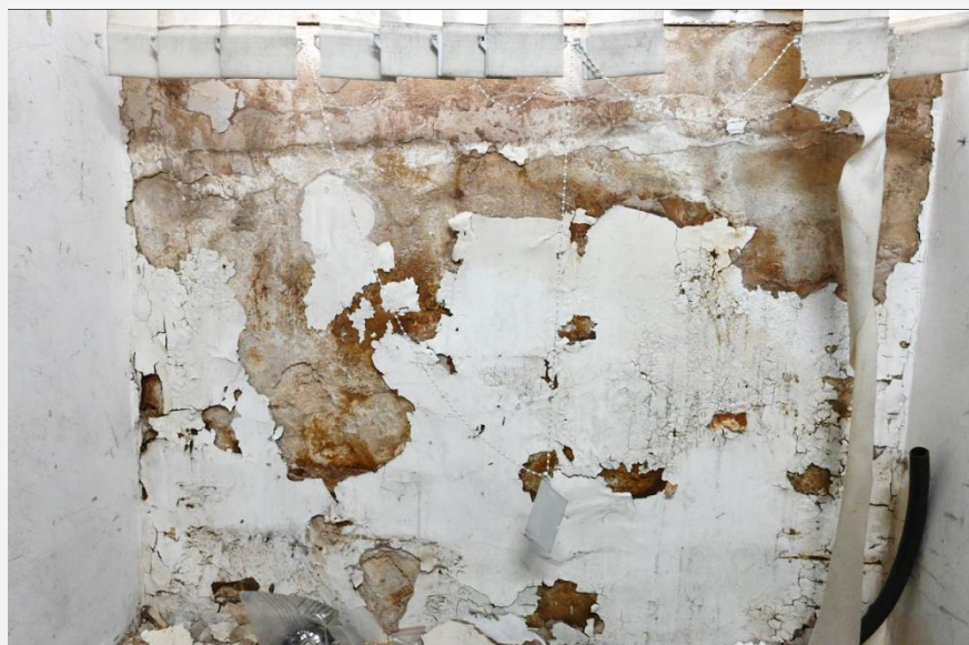
Foto 2. Acercamiento al deterioro
