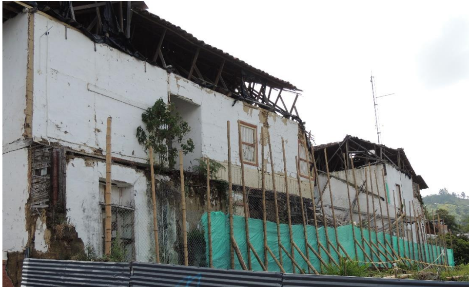
Ilustración 34 Estado Actual de la Crujía Oeste vista externa. Fuente Propia.
