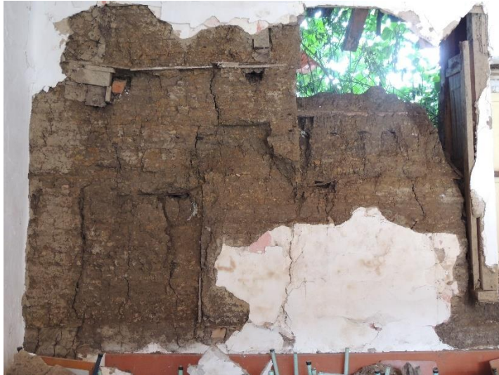
Ilustración 36 Espacio 101 Lateral Oeste Muro en tapia afectado por exposición. Fuente propia.
