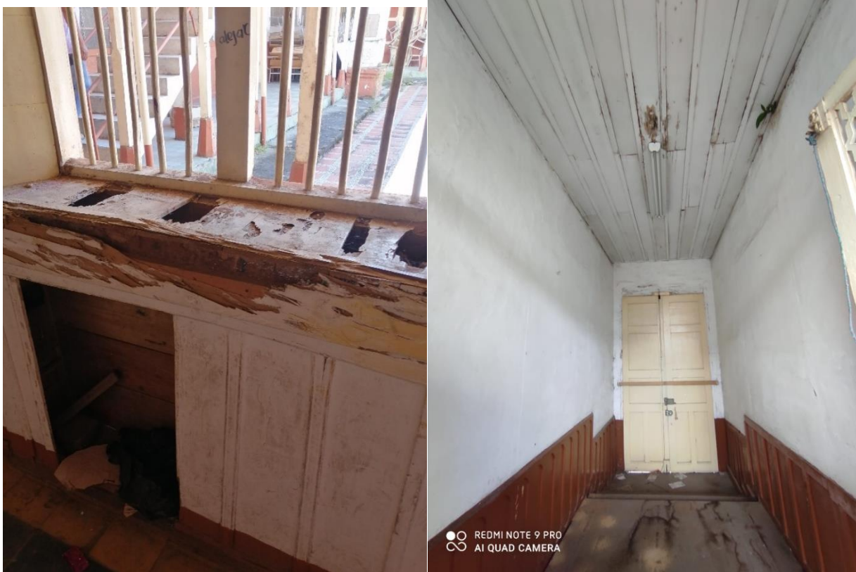
Ilustración 38 Derecha. Espacio 205 acceso por carrera 7, afectación en cielo y piso por humedad de cubierta.
