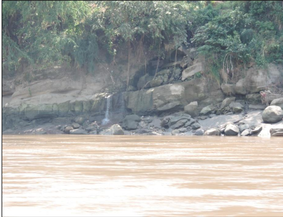
Figura 23. Vertimientos de aguas negras al río Magdalena, ronda de Flandes (2). Fuente:
