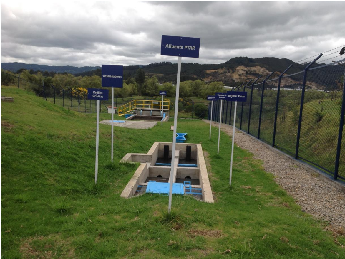
FÍGURA 9. Fotografía de la PTAR de la UMNG (BERNAL, 2013).
