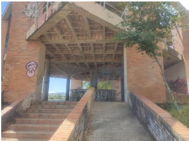
Ilustración 13. Mirador Ricaurte mal estado
