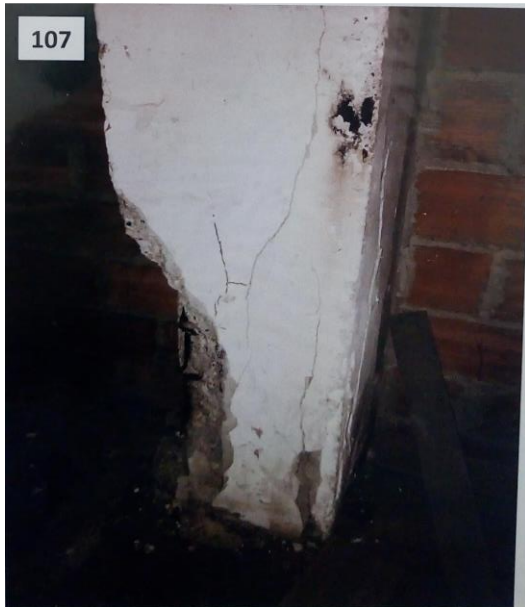
Ilustración 57 Desprendimiento y corrosión.
