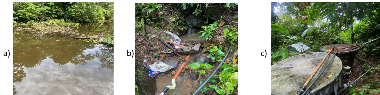
Ilustración 1 Zona de captación. (a) Lago de captación; (b) Bocatoma y tuberías de captación; (c) Desarenadores y tanques de sedimentación.
