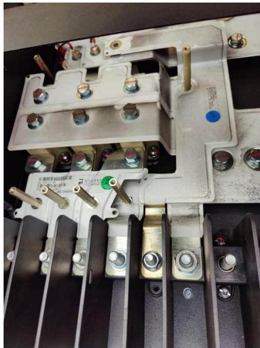
Fig. 8 Carboncillo encontrado al interior del variador de velocidad.
